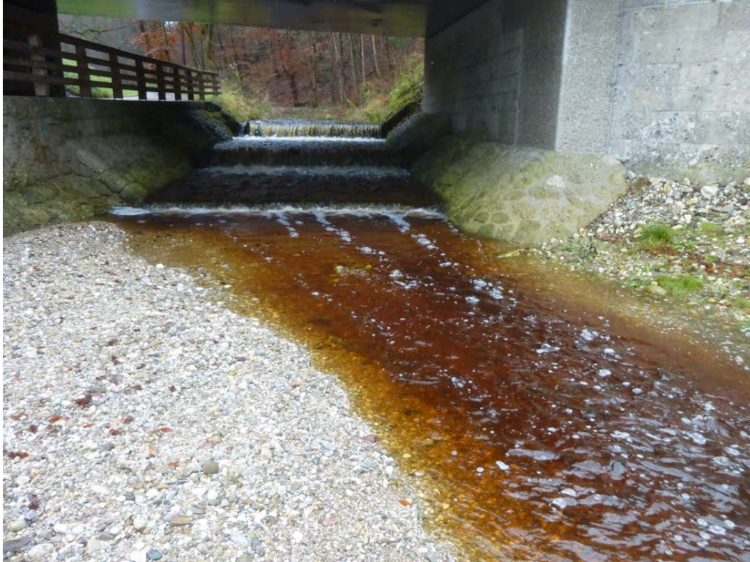
Abb. 1 Schaumbildung an den Kaskaden unter der B306 (Sparzer Graben)
