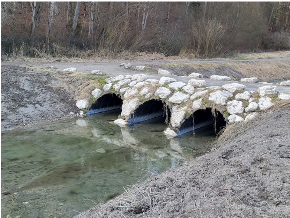
Abbildung 2: Die Querung über den Siechenbach ist neu gebaut und höher gelegt. Spaziergänger und Fahrradfahrer können sie nutzen, ohne nasse Füße zu bekommen, wie es bei der alten Brücke häufiger der Fall war. Foto: Wasserwirtschaftsamt Traunstein
