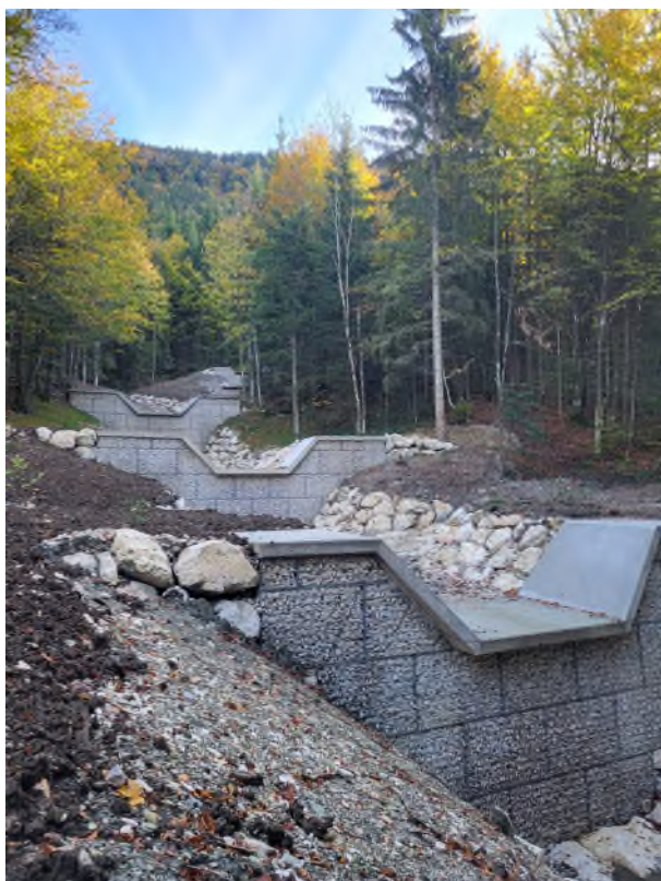
Abbildung 1: Neue Wildbach-Sperren haben die Arbeiter der Flussmeisterstelle Traunstein am Teisenberg bei Inzell errichtet. Die fünf Bauwerke ziehen sich auf einer Länge von rund 100 Metern den Hang hinauf. Foto: Wasserwirtschaftsamt Traunstein
