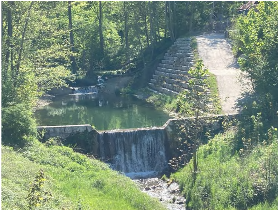
Abbildung 1: Die sanierte Sperre in der Ponlach bei Tittmo- ning. Dank der neu an- gelegten Abfahrt kann der Rückhalteraum re- gelmäßig freigeräumt werden von Totholz und Geröll. Die Böschung der Abfahrt ist so gestal- tet, dass sich kleine Hohlräume ergeben. In ihnen können Eidech- sen und Schlangen Rückzugsmöglichkeiten finden. Foto: Wasserwirt- schaftsamt Traunstein
