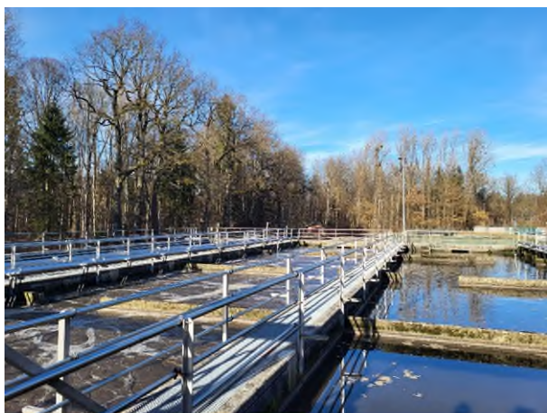
Abbildung 1: Die Kläranlage Bad Reichenhall verfügt über vier Belebungsbecken. Foto: Wasserwirtschaftsamt Traunstein
