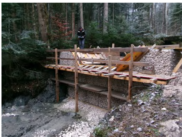
Abbildung 1: Sperren aus Gabionen können in ganz unterschiedlichem Gelände verwendet werden, denn die Gabionengitter sind sehr flexibel. Per Hand oder mit einem Bagger befüllen sie die Arbeiter mit Steinen. Damit die Sperren nicht beschädigt werden von Geröll und Geschiebe bekommen sie einen „Deckel“ aufgesetzt, aus Holz oder aus Beton. Foto: Wasserwirtschaftsamt Traunstein
